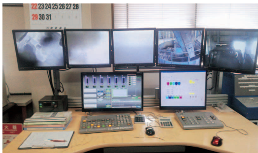
バッチャープラント操作盤
